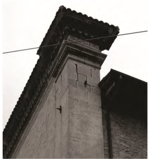
Figure 4. L'Aquila, chiesa di S. Flaviano, metal anchors of façade 'radiciamenti'.
