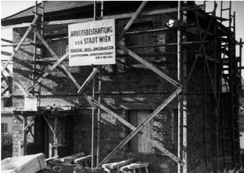
Abb. 64 Zweifamilienhaus des Assanierungsfonds mit zwei Wohnungen und gemeinsamer Stiegenhausanlage unter einem Walmdach im Bau. [Rudolf Spiegel 06.1934].
