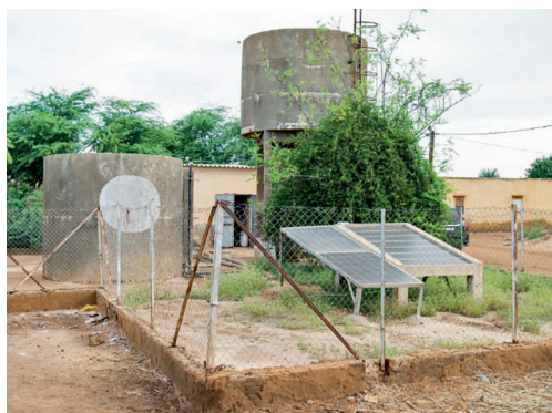
Panneaux solaires de la station de Guidakhar (Sénégal)
