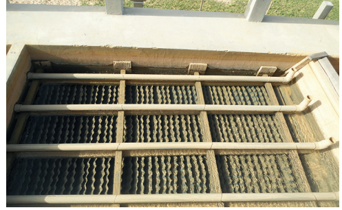
Décanteur lamellaire, station de Ziré (Mauritanie)
