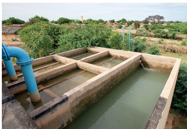
Décanteur de la station Mbilor (Sénégal)
