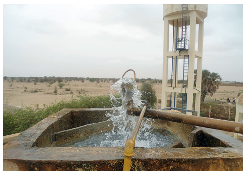
Bassin de mélange, station de Thiago (Sénégal)
