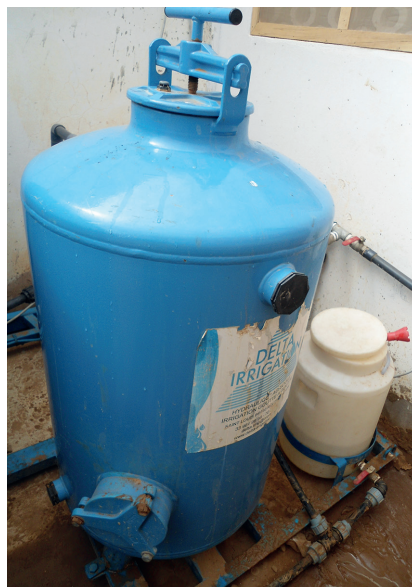
Filtration rapide sous pression, station de Ross-Béthio (Sénégal)
