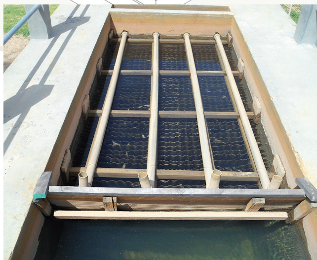
Décanteur lamellaire à flux ascendant, station de Ziré (Mauritanie)
