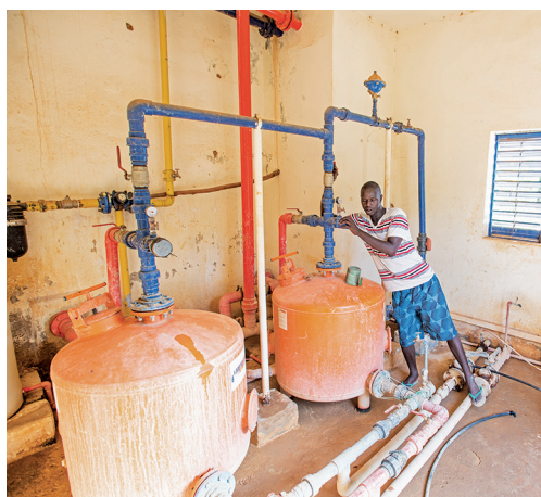
Filtration rapide sous pression, station de Thiago (Sénégal)
