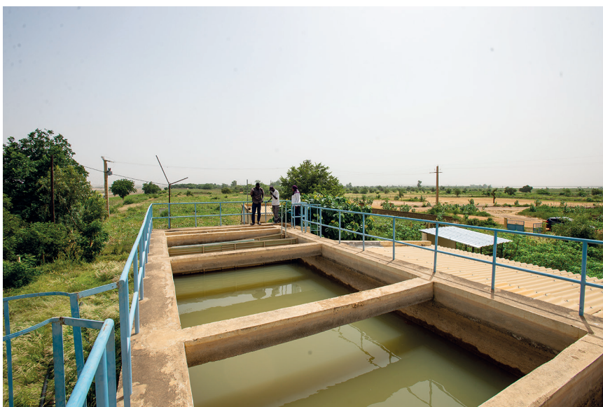
Décanteur à flux horizontal de Diawara (Sénégal)
