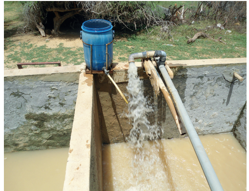
Injection de sulfate d'alumine, station de Tékane (Mauritanie)
