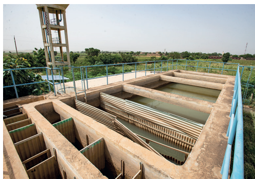
Flocculateur à chicanes, station de Diawara (Sénégal)
