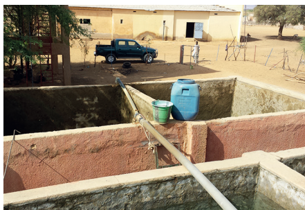
Suivi des paramètres de l'eau à Guidakhar (Sénégal)
