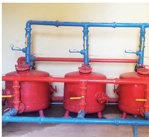
Filtration rapide sous pression, station de Thillé Boubacar (Sénégal)
