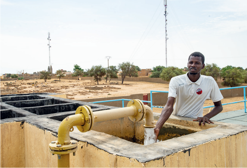
Bassin de mélange et flocculateurs de Thillé Boubacar (Sénégal)
