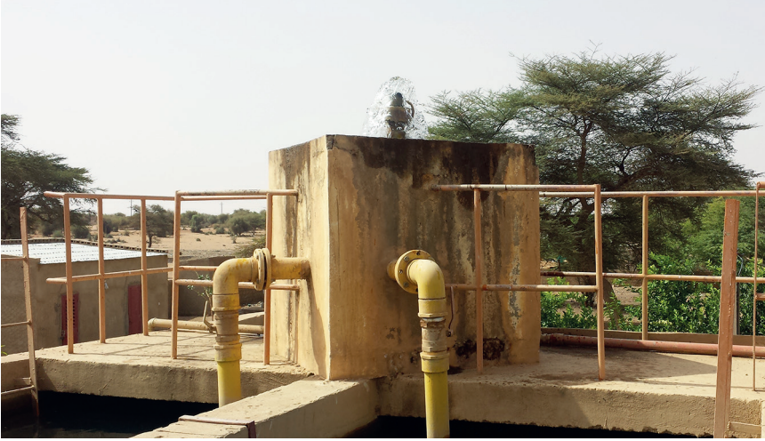
Bassin de mélange de Bokhol (Sénégal)
