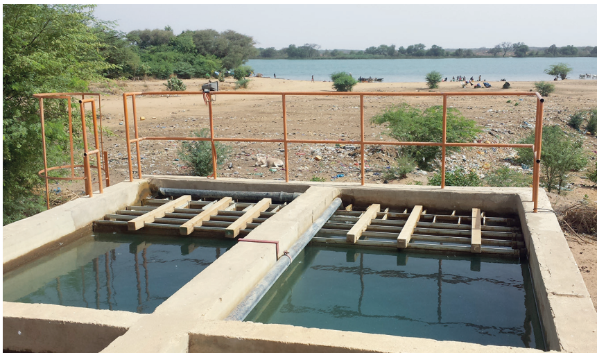
Floculateurs à chicanes en aluminium de la station de Bokhol (Sénégal)
