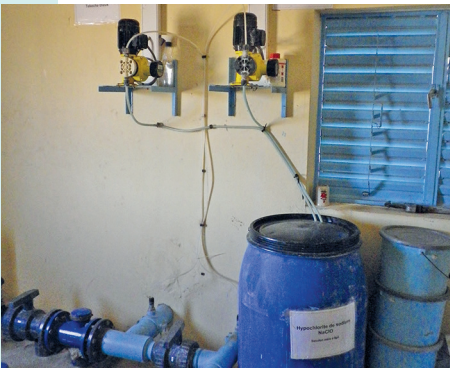
Système d'injection par pompe doseuse électrique
