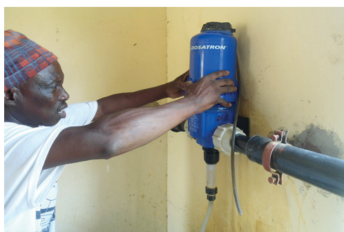
Entretien de la pompe doseuse hydraulique, station de Guidakhar (Sénégal)
