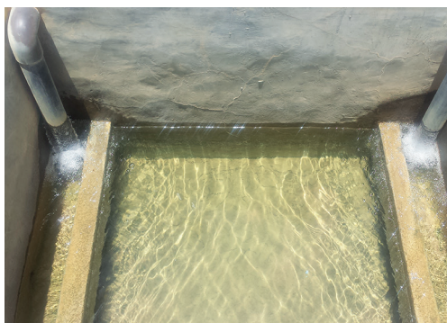
Filtre à sable à l'air libre, station de Breun (Mauritanie)
