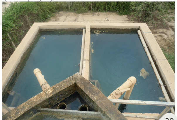
Décanteur statique à flux vertical, station de Thiago (Sénégal)
