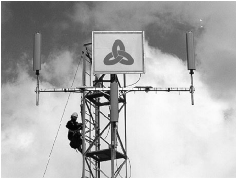
Figura 4. "Antenna intelligente ad "array" (antenna "a schiera") per GSM installata su una cella sperimentale a Milano.
