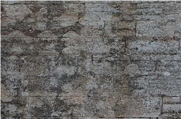
Figura 109. Chiesa di San Nicolao a Monsummano Alto: particolare del degrado superficiale della muratura
