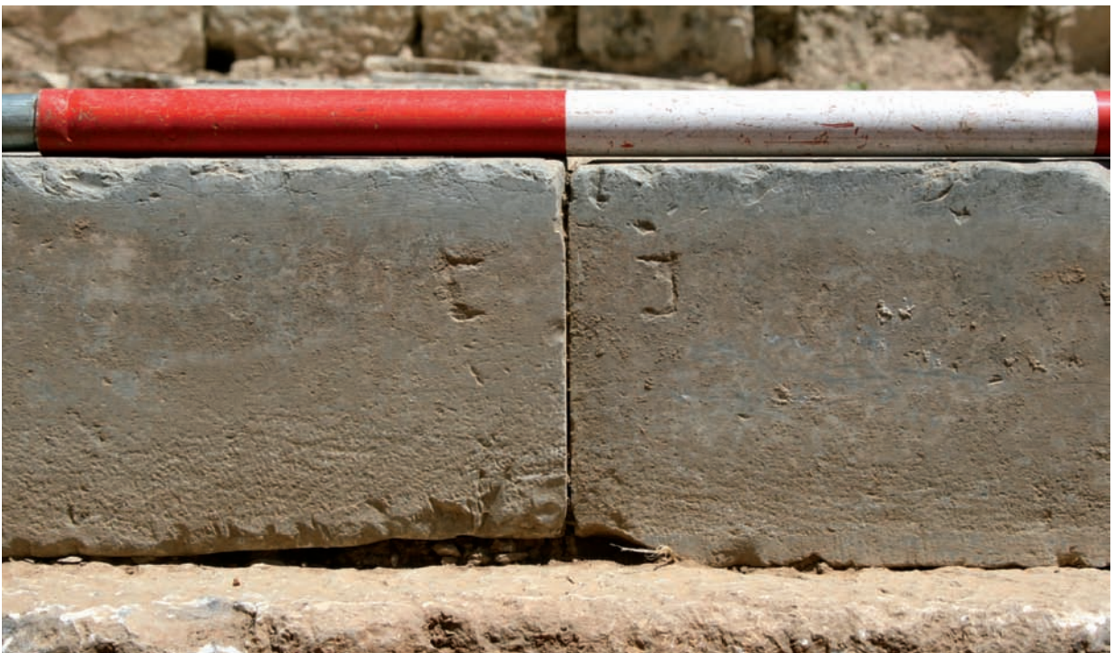
2 ›Hestiasaal‹. Zentrales Fundament für Anrichte. Freigelegte Westseite mit Versatzmarken zur Verlegung der Blöcke
