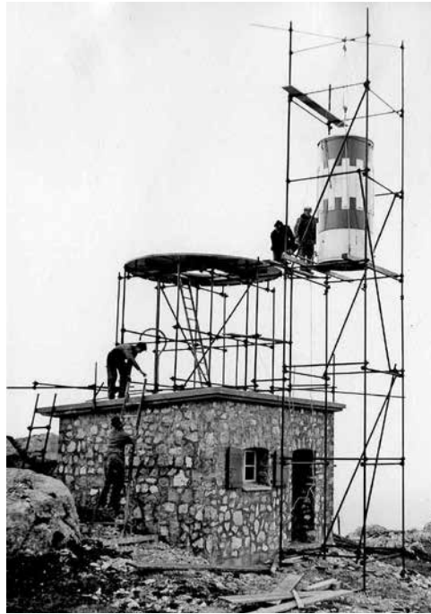
Abb. 18: Versuchsweise Errichtung eines VOR auf der Dôle im Jahr 1956. Quelle: BAR, E 8150 (A) 1967/114, Bd. 13: Office fédéral de l'air, Section de la sécurité aérienne, Service de radio-calibration: Essai d'un émetteur TVOR sur le sommet de la Dôle du 20 décembre 1956.
