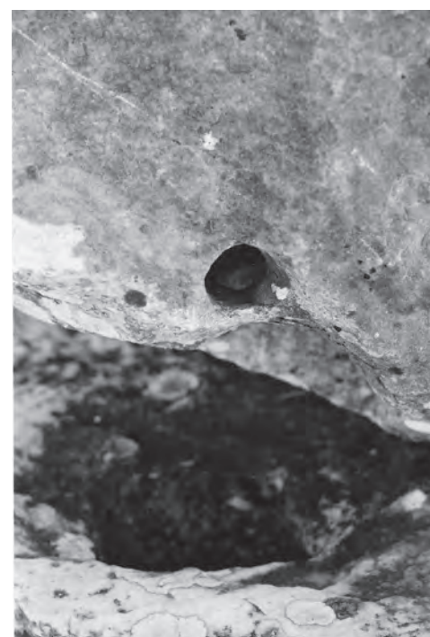
Abb. 92: Architekturprobe Südostecke mit dorischem Eckarchitrav B06/1706 und Ecktriglyphenblock B06/1707 mit seitlich gebohrtem Gusskanal zu innenliegendem Dübel
