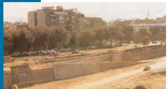
Figura 29 I lavori di realizzazione degli accessi e delle discese ai margini del fiume.
