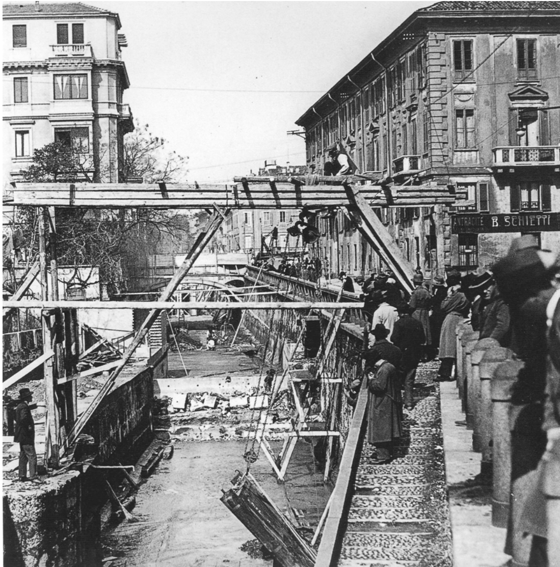
Figura 77 Lavori di copertura della cerchia dei navigli in via Senato e in via San Damiano, 1929, Milano, Civico Archivio Fotografico del Castello Sforzesco.
