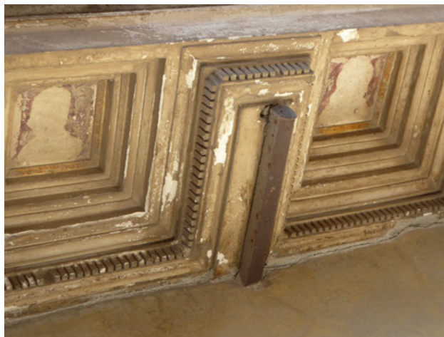
Abb. 9: Casa del Fauno, Fauces (7/53), Ostwand, Kassettierung der Unterseite des Stuckgebälks.
