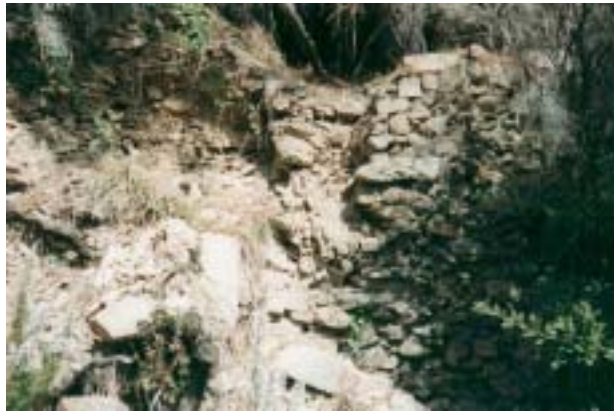
Fig. 36 Il crollo di un muretto a secco abbandonato.
