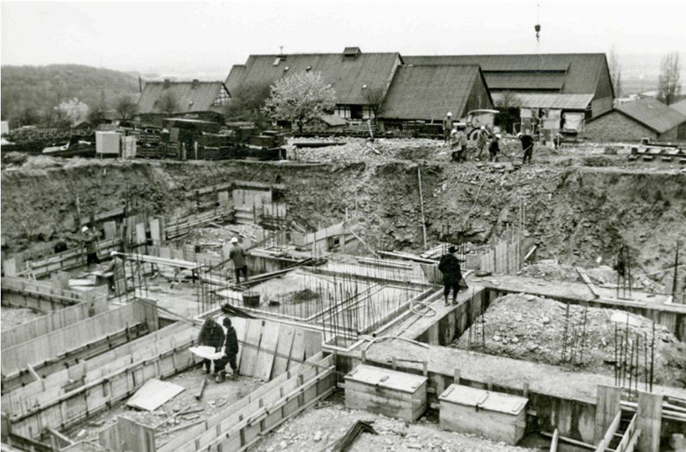
Abb. 104: Blick auf die Baustelle der Institute für Jagdkunde und Zoologie der Forstlichen Fakultät in Göttingen, Mai 1965 (Quelle: UniA GÖ, Forst. Fak. Nr. 58, Anlage zu einem Aktenvermerk von Professor Schober vom 6. Mai 1965).
