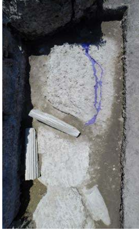
Figura 14. Foto detalle del derrumbe occidental en el que se pudo apreciar el desprendimiento conjunto de la pared del muelle y las estructuras arquitectónicas de la parte superior.
