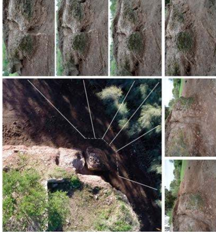
Figura 51. Vista general y de detalle de la fractura de la plataforma adosada.
