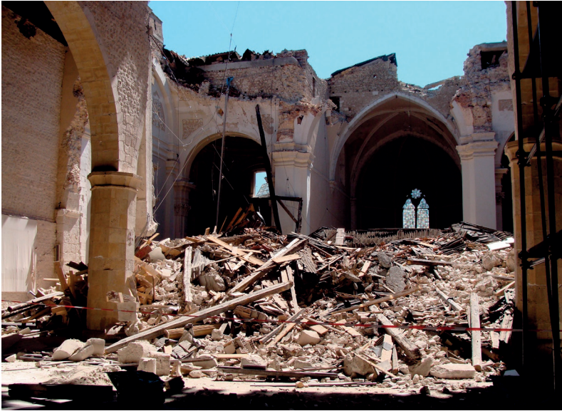
Figure 1.3 Santa Maria di Collemaggio: the post-earthquake collapse (2009).
