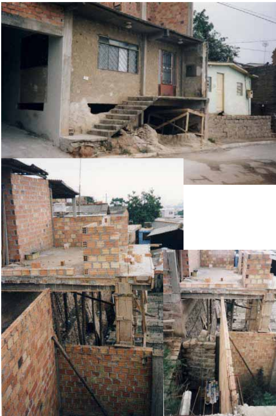
Fig. 65 - Ordine e rispetto del prossimo: è quanto la Regolarizzazione Fondiaria di Vila Campo da Tuca non è stata in grado di introdurre in tutto il quartiere. Nonostante gli sforzi del processo partecipativo, in alcune aree si continua a costruire abusivamente sui pubblici marciapiedi, o persino piantando le fondamenta delle proprie sopraelevazioni dentro l'abitazione del vicino...
