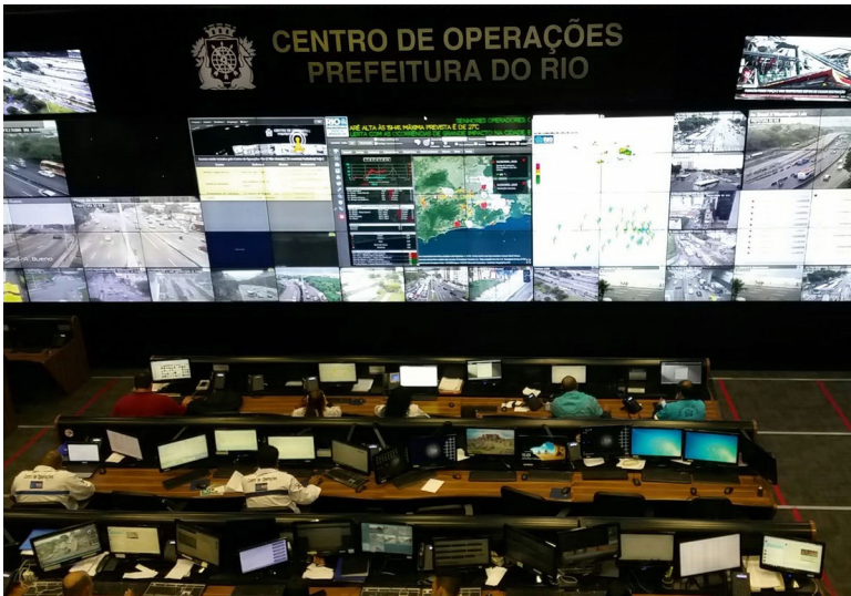
Abb. 5: Kontrollraum des Centro de Operações (COR) in Rio de Janeiro. Foto: Leon Hempel | ZTG 2019.
