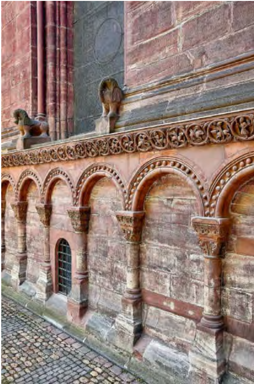
ABB. 194 Östliche Chorwand, um 1180, mit Blendarkatur auf Säulchen, Fries (Kopie) und zwei Elefanten (Kopien) als Säulenträger des Fensters. Die Säulchen stehen auf hohen Sockeln, die Kapitelle mit Palmettenornamentik sind durchwegs noch original erhalten. Foto Peter Schulthess, 2018. DpfBS.
