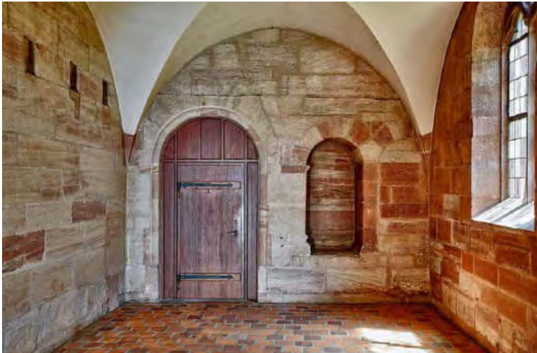
ABB. 450 Katharinakapelle, um 1470. Der eigentliche Kapellenraum liegt im Erdgeschoss und schliesst mit der östlichen Stirnwand an den Kreuzgang an, zu dem sich eine Tür und einst ein heute zugesetztes Biforium öffneten. Darüber ist die Nut für die Decke des flach gedeckten Vorgängerraums zu erkennen, dessen Deckenbalken in den rechteckigen Öffnungen in der Nordwand (l.) lagerten. Foto Peter Schulthess, 2018. DpfBS.
